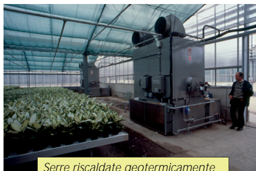
Serre riscaldate geotermicamente in Toscana, Italia (foto F.-D. Vuataz)
